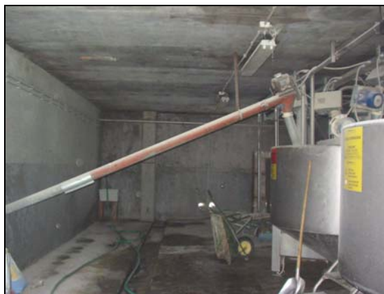
Figura 89 – Vasche di preparazione e distribuzione della broda
